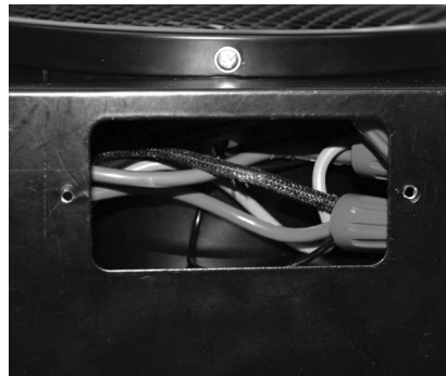
Figura 14: Las conexiones de cable apretadas con cuidado en el compartimiento de cableado.
