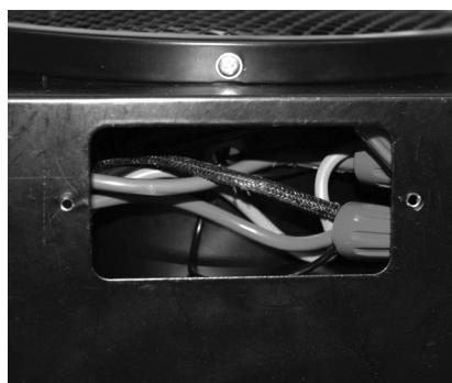
Image 14: Les connexions de câble sont soigneusement introduites dans le compartiment de raccordement.
